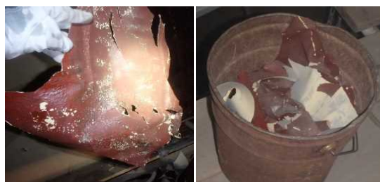
剥離した被膜片（産業廃棄物）
