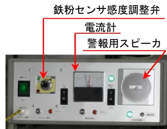
制御システム
